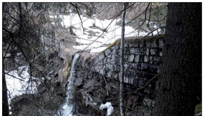
Sehr schlechter Bauwerkszustand der Konsolidierungssperren im Vergeinbach im Bereich des unteren Sperrenstaffelungsabschnittes.
